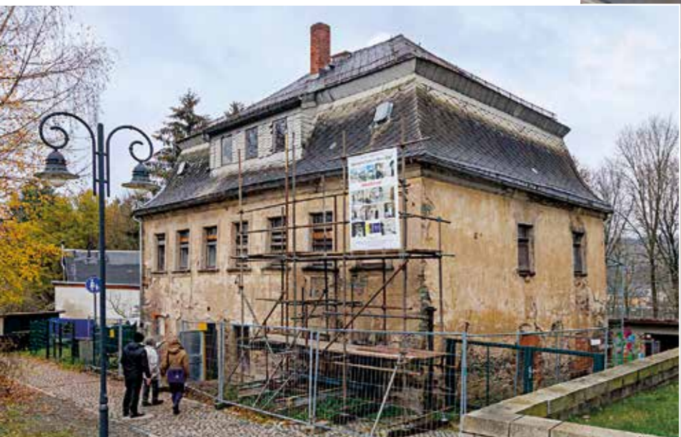
▲ Die Mauern sind voller Risse und verformt, aber das Dach ist dicht: das barocke Trampeli-Haus mitten in Adorf.
